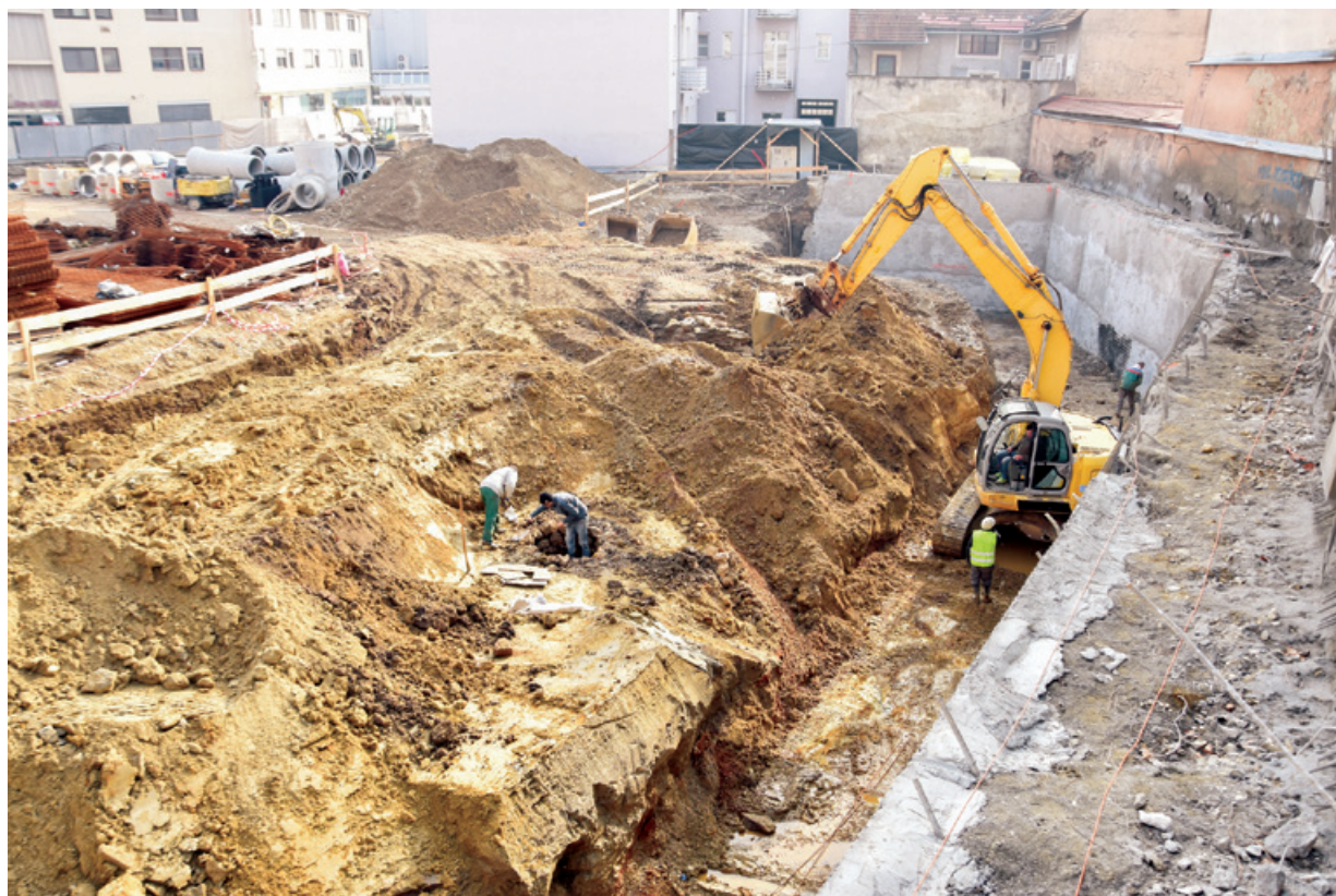
Odstranjevanje arheoloških ostankov je neredko potekalo tik pod zobmi gradbenih strojev; na sliki dokumentiranje ostankov poznosrednjeveškega vodnjaka (foto: A. Šinkovec).
